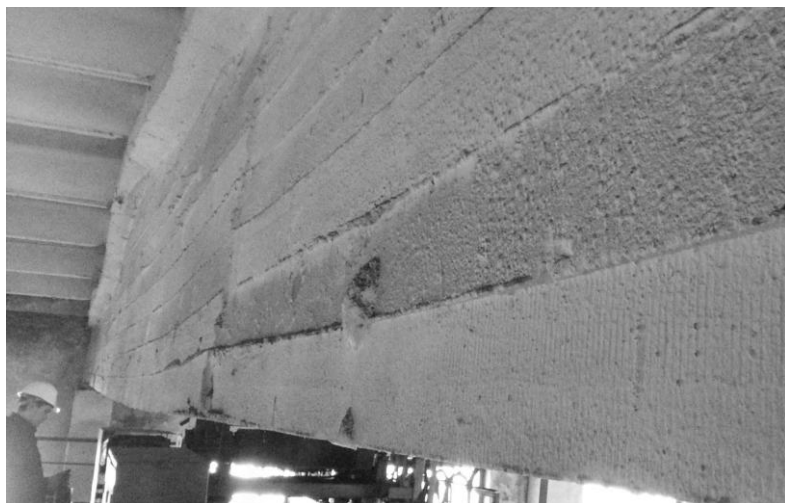
Рис. 1. Балки покрытия пролета Б-В в осях «2-9» изготовлены в деревянной опалубке и изначально имели прогиб до 70 мм
