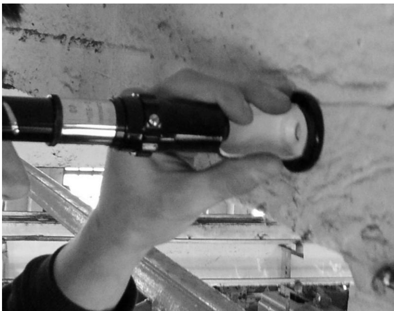
Рис. 2. Определение ширины раскрытия трещины в балке покрытия по оси «9» пролета «А-Б» с помощью микроскопа Мир-2
